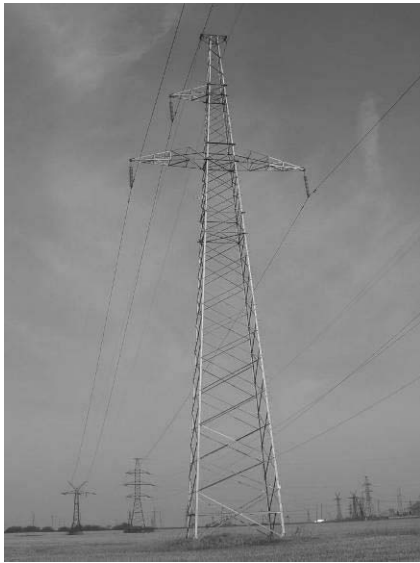
в) опора ВЛ 220 кВ
