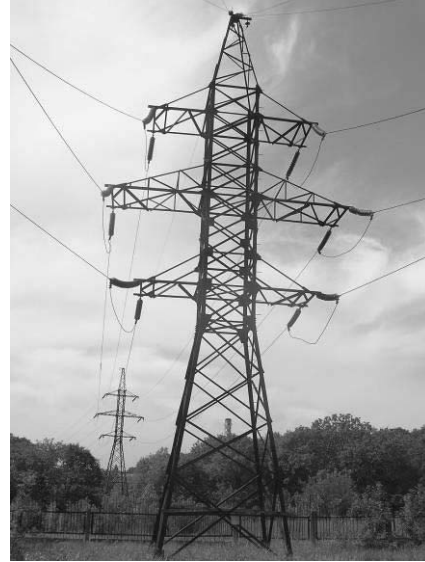
б) опора ВЛ 110 кВ
