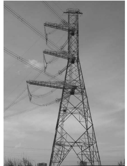
д) опора ВЛ 500 кВ
